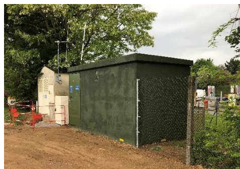
Poste de livraison (Crédit photo : SERGIES, 2015)
