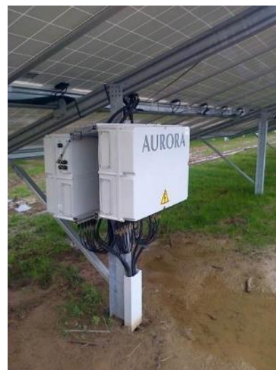
Figure 20 : Boîtier de connexion fixé à l'arrière des panneaux (Crédit photo : SERGIES, 2015)
