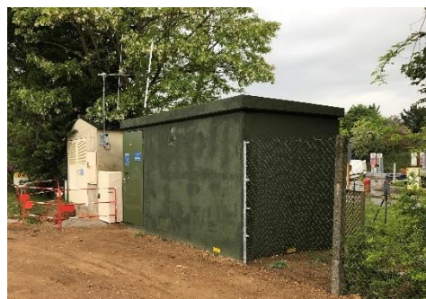
Figure 23 : Poste de livraison (Crédit photo : SERGIES, 2017)
