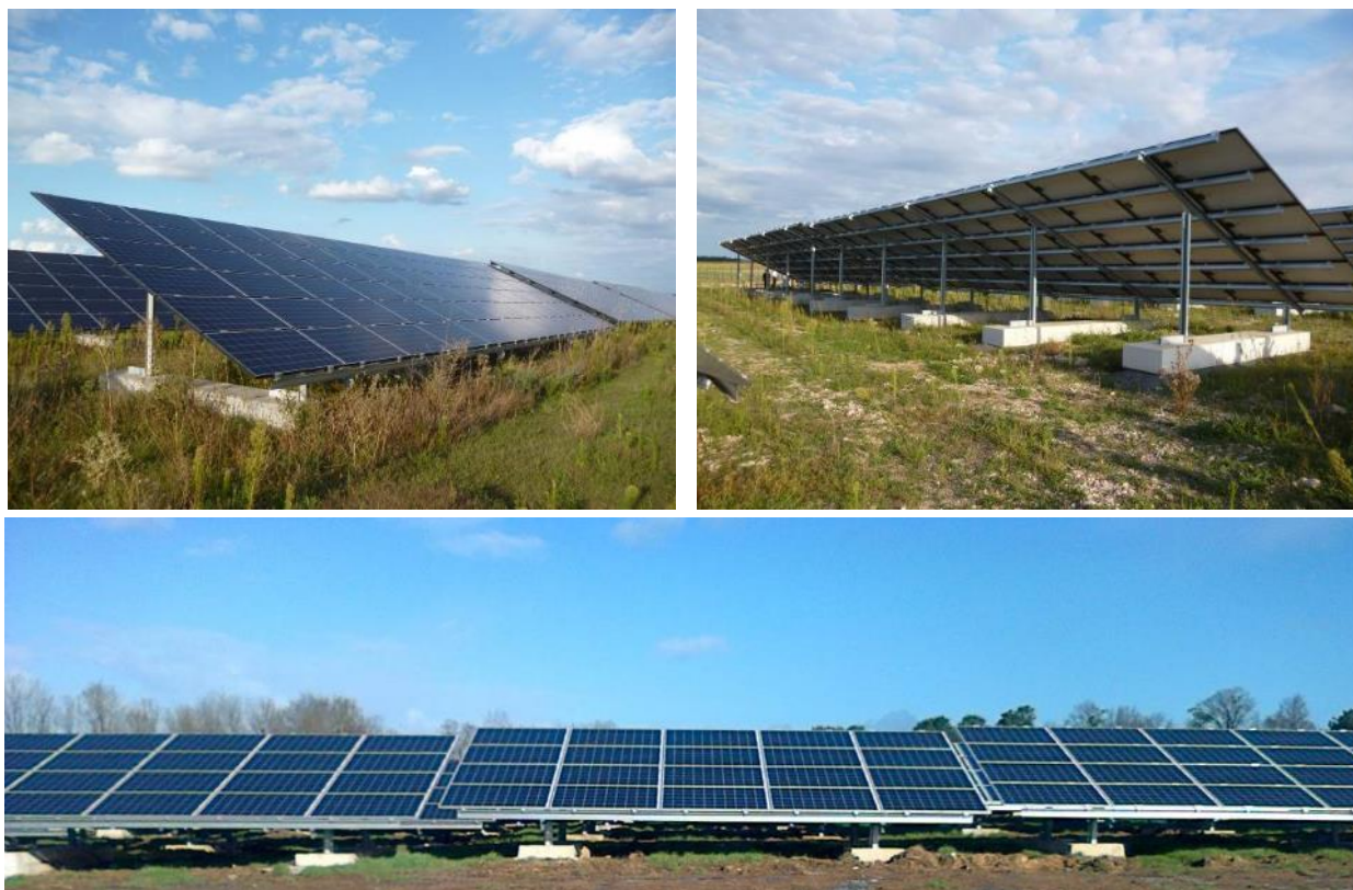
Installations en fonctionnement
