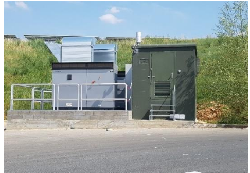
Figure 21 : Poste de transformation (Crédit photo : SERGIES, 2017)
