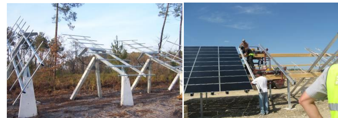
Photographie 6 : Montage des supports (à gauche), montage module (à droite) Source : EDF Energies Nouvelles
