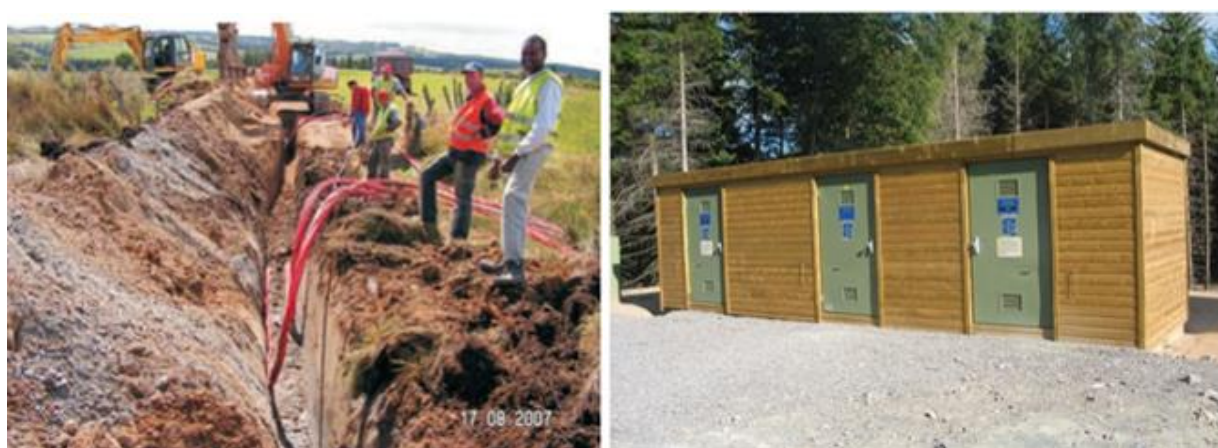
Photographie 7 : Déroulage et pose des câbles (à gauche), poste de livraison (à droite) Source : EDF Energies Nouvelles
