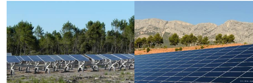
Photographie 1 : Structures solaires (à gauche: les trackers de la centrale de Gabardan (40) qui suivent le soleil ; à droite : structures fixes à Puylobrier (13)) - Source : EDF EN France
