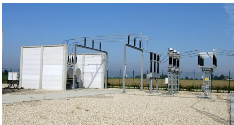
Exemple de cellule transformateur avec ses murs pare-feu, disjoncteurs et sectionneurs 90 000 volts
