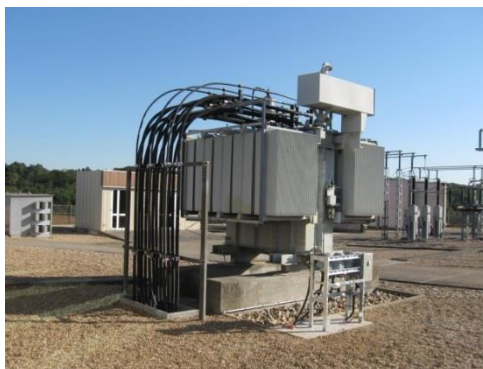
Un autotransformateur 20 000/15 000 Volts 10 MVA ONAN
