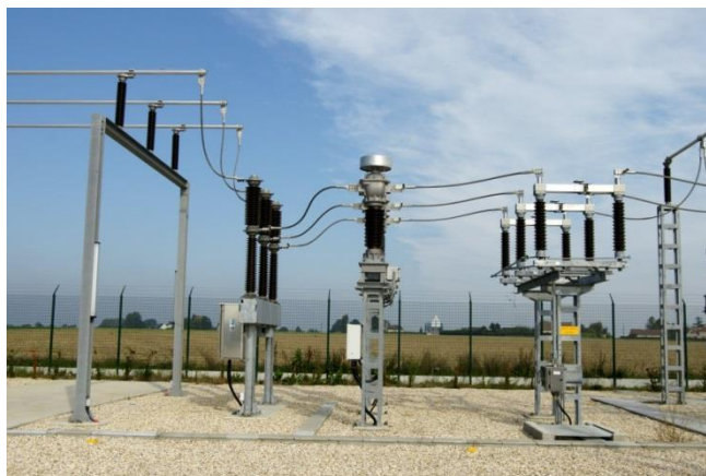
Exemples d'équipements mécaniques (charpentes) et électriques extérieurs à 90 000 volts (connexions, disjoncteur, combiné de mesures, sectionneur)
