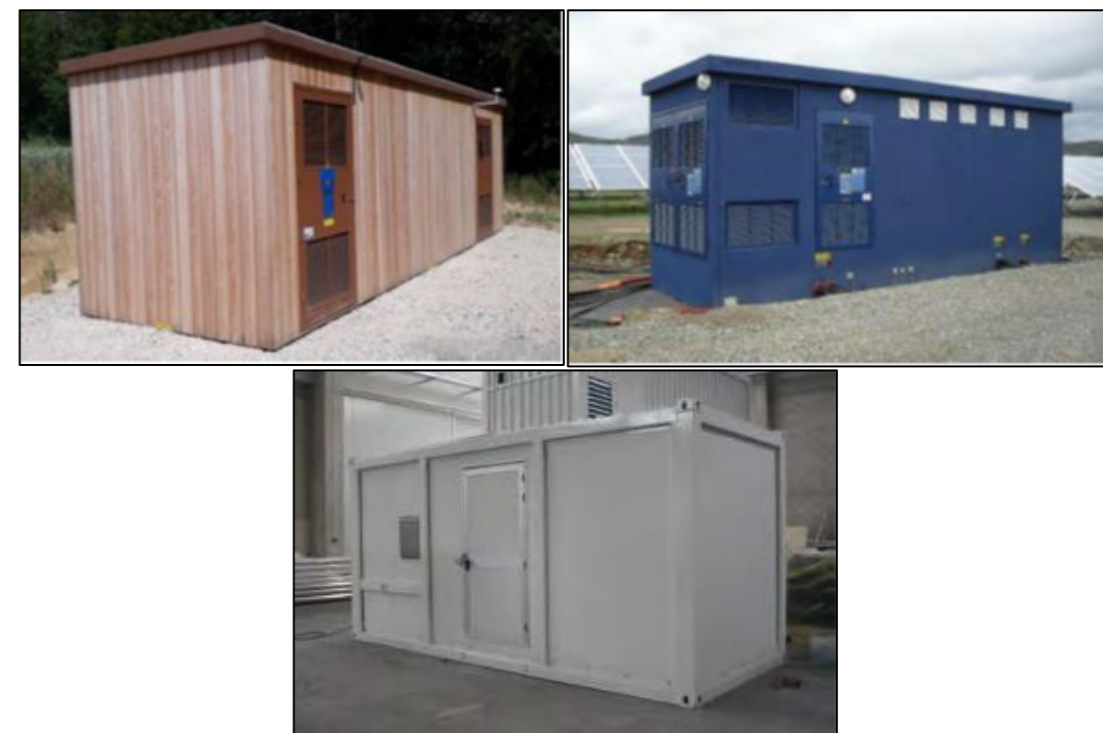
Figure 10 : Exemple d'onduleurs et transformateurs installés à l'extérieur, dans un local bardage bois (gauche), dans un local en béton (droite), dans un container (bas) (Source : AMEL)
