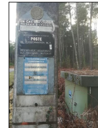
Figure 13 : Poste de transformation
