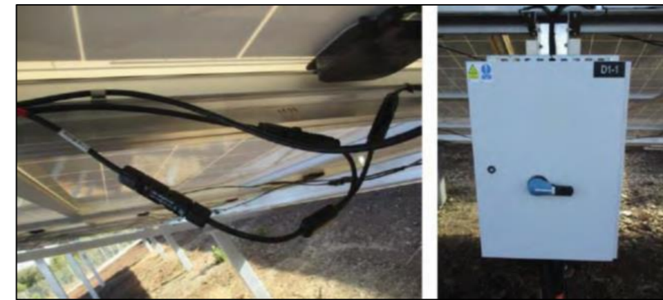
Figure 9 : Exemple de câble électrique et boîte de raccordement (Source : AMEL)
