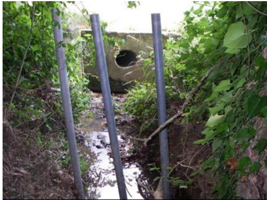
Illustration 11 : Seuil en aval de l'A6 au niveau du Bois de la Duchesse (APRR)
