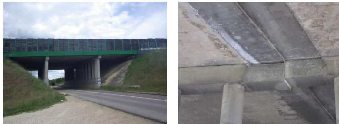
Illustration 5 : Pont autoroutier au dessus de la RD6 et interstices favorables aux chauves-souris
