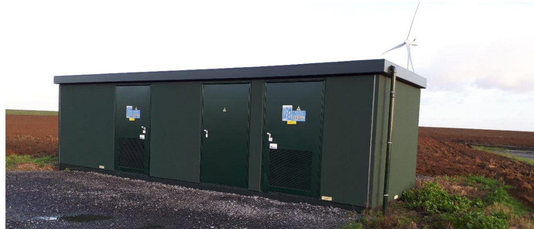
Figure 10 : Exemple de poste de livraison (cf Parc éolien de la Chaussée Brunehaut, JPee)
