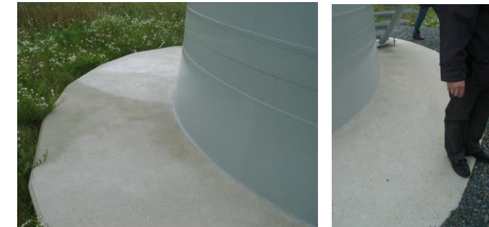
Exemple de finition au pied d'une éolienne parc éolien d'Erbray-Soudan (49)
