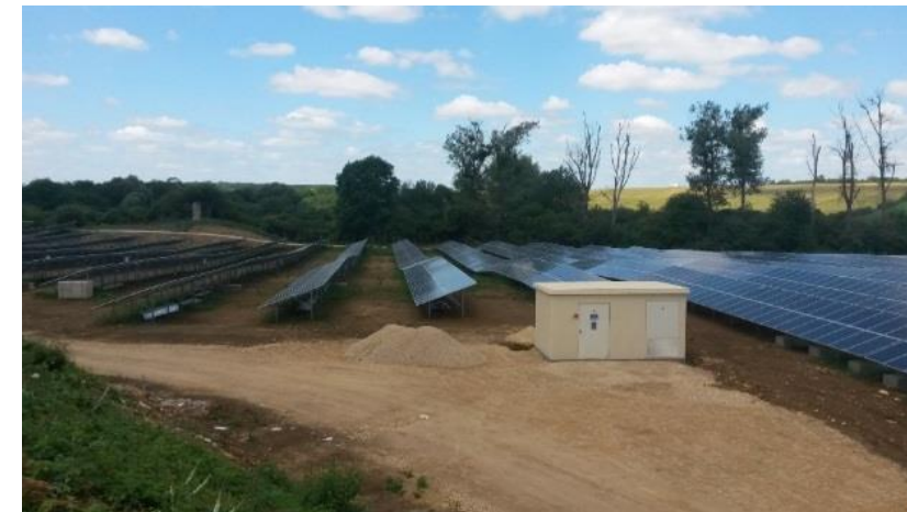
Figure 8 : Exemple de poste de livraison électrique (source : Quadran, 2018)
