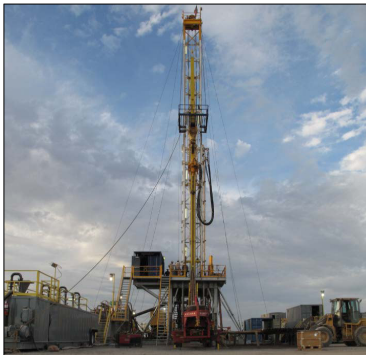
Figure 4 : Illustration de la machine de forage qui sera utilisée pour réaliser le puits BO-12, avec le mât relevé, les bacs à boue à gauche, les racks supportant les tiges à droite du mât.
