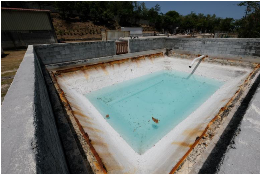
Figure 30 : Bassin de rétention bétonné sur la plateforme des puits actuelle destiné à recueillir le fluide géothermal déchargé durant les phases transitoires d'ouverture et de chauffe des puits, et de maintien en température.
