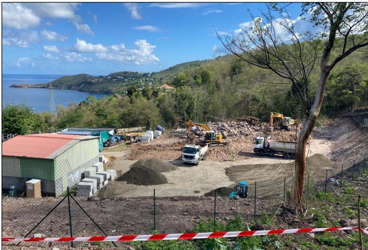
Figure 7 : Vue (vers le Nord) des travaux de terrassements de la plateforme de forage du puits BO-12 qui accueillera ultérieurement l'unité B1bis (source : Géothermie Bouillante).
