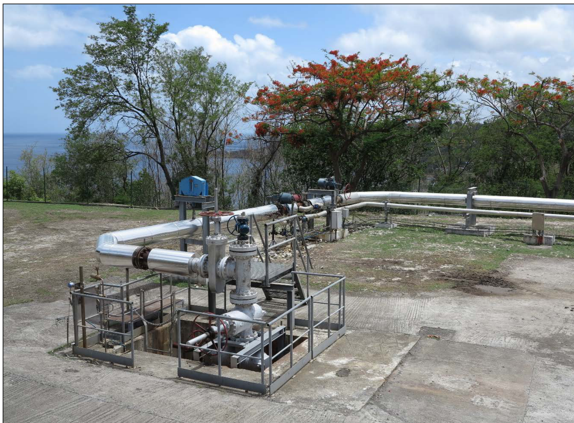
Figure 31 : Vue du puits BO-6 sur la plateforme de Plateau illustrant la tête d'un puits géothermique placée dans une cave bétonnée, munie de vannes d'isolement et connectée à une conduite de transport des fluides calorifugée.
