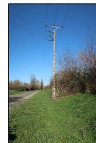
Ligne électrique à la limite Ouest du site Source : Artifex 2020
