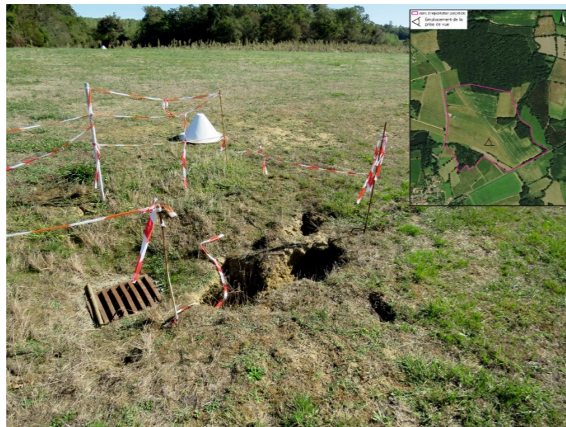
Figure 6 : figure d'affaissement du sol observée en bordure de la piste d'aérodrome présente sur la ZIP
