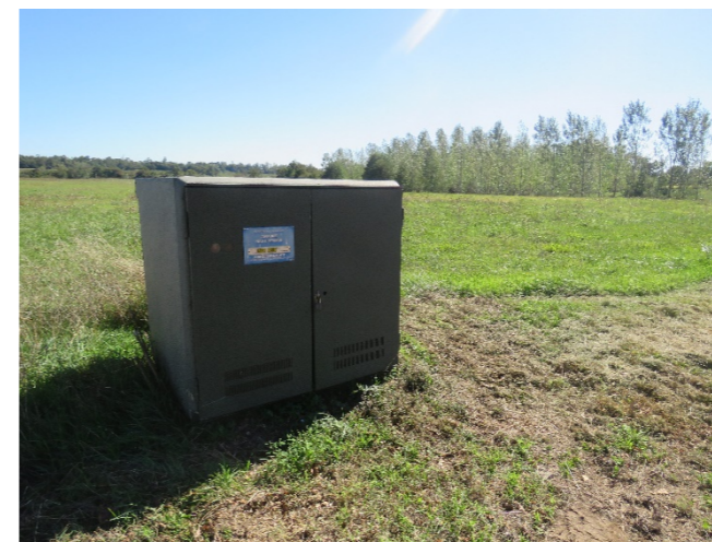
Figure 30 : armoire haute tension à l'ouest de la ZIP
